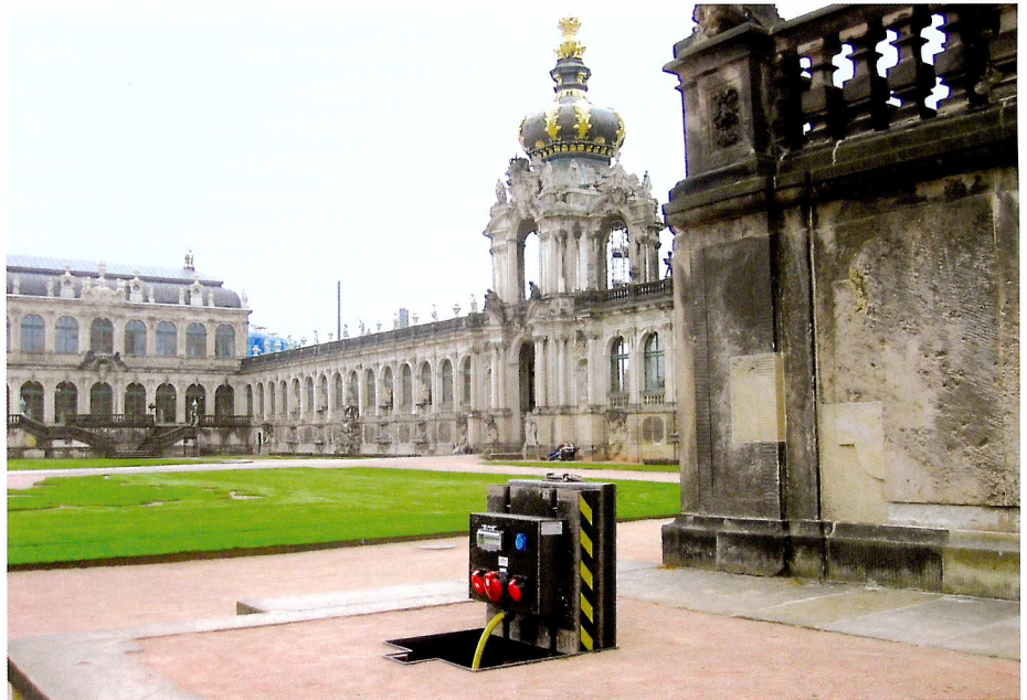
Unter gut versteckten Schachtdeckeln wie hier beim Dresdner Zwinger verbergen sich Unterflurverteiler.
