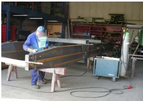
Abb. 10 Hohe mechanische und thermische Einwirkungen auf die Anschlussleitung des Elektroschweißgerätes
