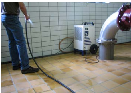
Abb. 12 Strahlwassereinwirkung auf Anschlussleitung und Betriebsmittel
