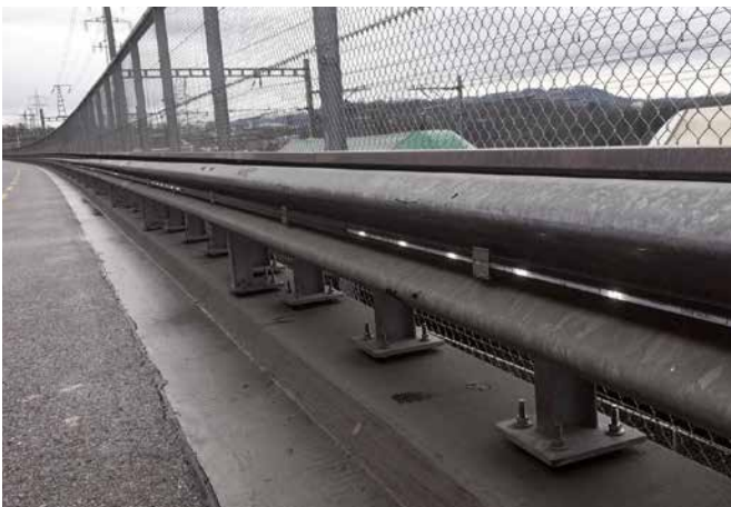
Beleuchtung Radweg, Ittigen
