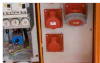
90° schwenkbares Abnehmerteil ist schräggestellt – dadurch keine Verletzungsgefahr
