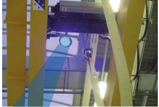
Sicherheitsbeleuchtung an Deckenkran
