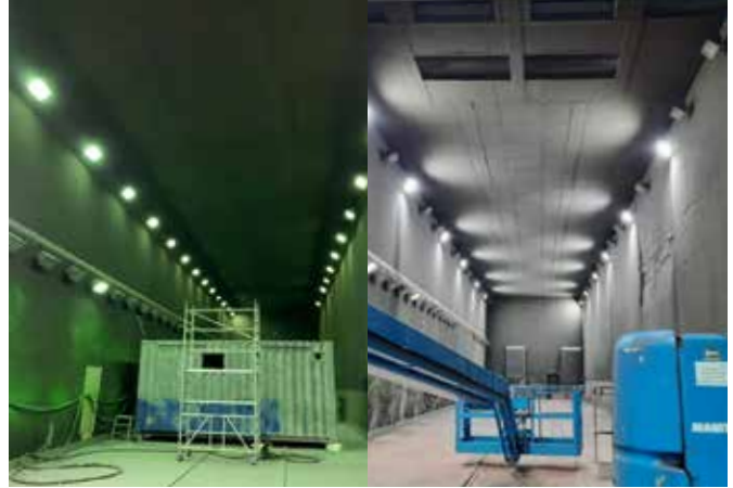
Beleuchtung Strahlhalle (vorher/nachher)
