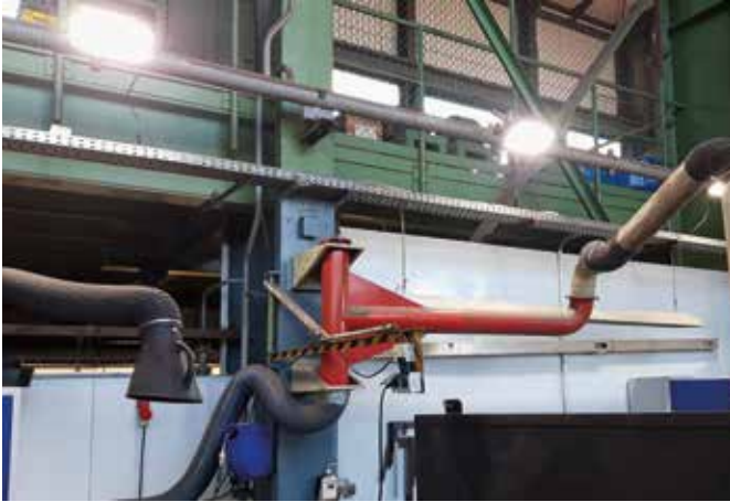
Beleuchtung Industriewerkstatt mit Schweißarbeitsplatz
