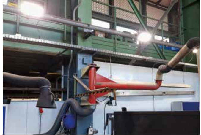
Beleuchtung Industriewerkstatt mit Schweißarbeitsplatz
