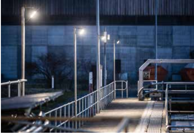
Areal- und Wegebeleuchtung in einer Kläranlage
