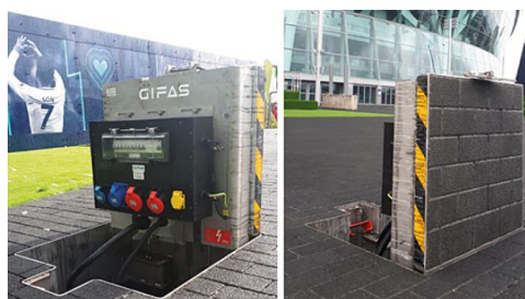
Historische Plätze, Fußgängerzonen oder Sportplätzen werden mit Versorgungstechnik ausgestattet, ohne das Ambiente zu stören (Bild: Gifas)
