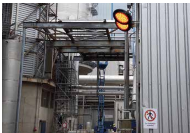
LKW Signalanlage mit DeltaLUXX RED
