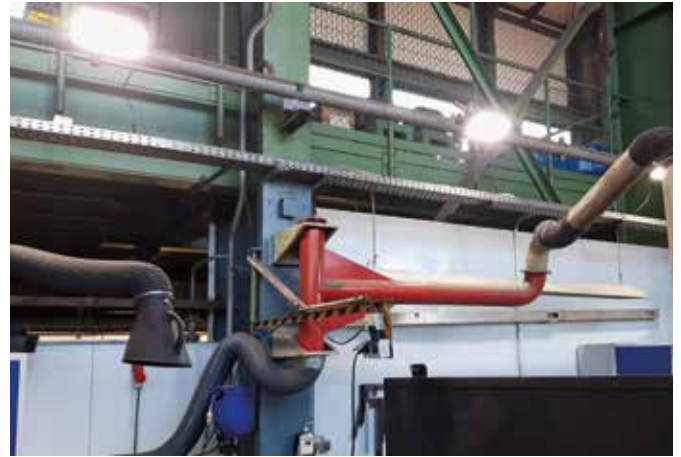
Beleuchtung Industriewerkstatt mit Schweißarbeitsplatz
