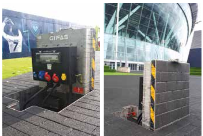
Tottenham Hotspur Station, PIAZZA 700 und PIAZZA 1000
